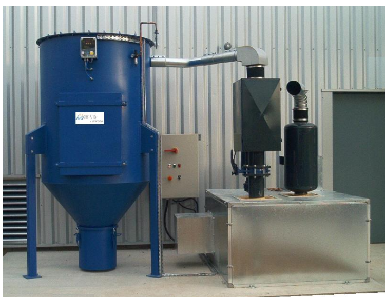
Centrale d'aspiration dans un silo
